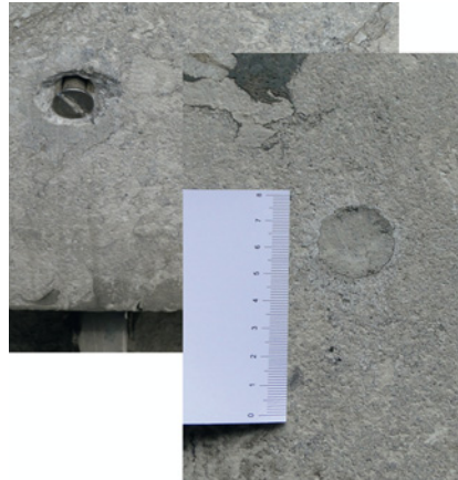
Rathaus Mainz: Nachträgliche Sicherung der Fassadenplatten und Kaschierung, leider nicht rückgängig zu machen.
