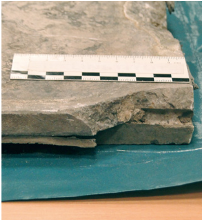
Rathaus Mainz: Ausbrüche an Fassadenplatten
