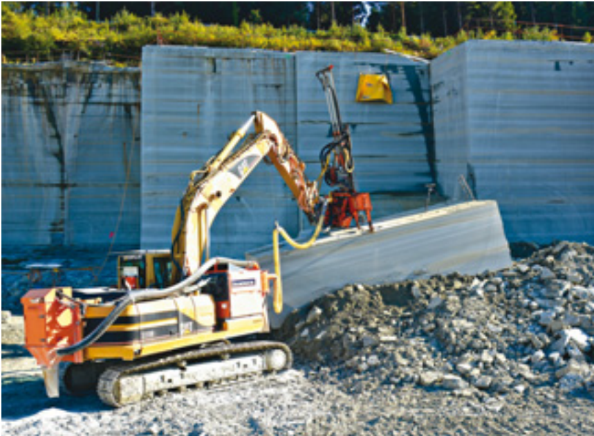
Aufgrund seiner Schichtung und Lagerung im Steinbruch lässt sich der Molassesandstein aus Rorschach relativ einfach und bequem abbauen. Fotos: Robert Stadler
