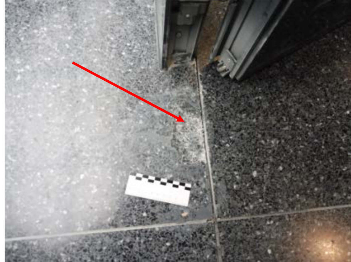
Ausdehnung des Hallenbodens durch Wärme (Fuge wurde nachgearbeitet, da rausgequollen) durch Druck Platte teilweise abgeplatzt
