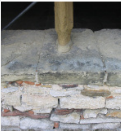
Vorzustand der Mauerabdeckung mit starken Absandungen Foto: Büro AeDis
