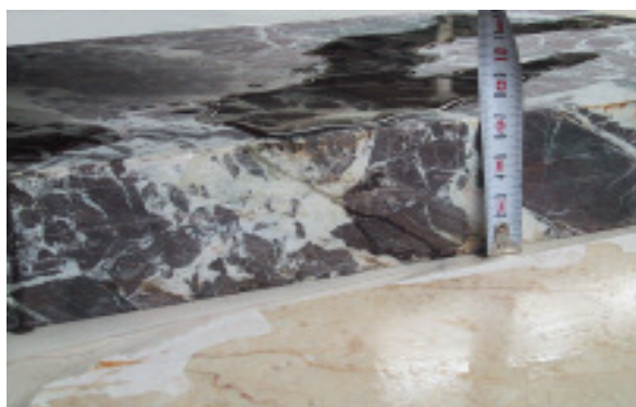
Das Harz füllt den Riss komplett, nicht nur oberflächlich. Fotos: B. Holländer; Firma
