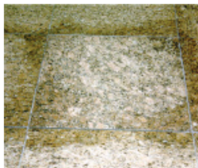
Durch die Verwendung von falschem Fugenmörtel hervorgerufene Verfärbung
