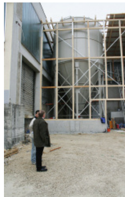
Bild 7: Wasseraufbereitungsanlage mit einer Kapazität von 200 m 3 /h
