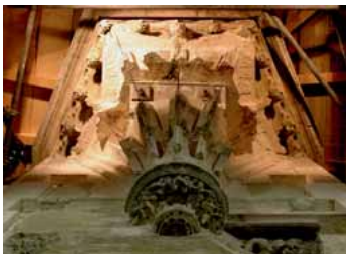
Abb. 8: Untersicht der freigelegten Konsole. Zu erkennen sind die Druckplatte der eingebauten Zugstäbe und einige Armierungsbügel für die Ergänzung der Maßwerkprofilierungen.
