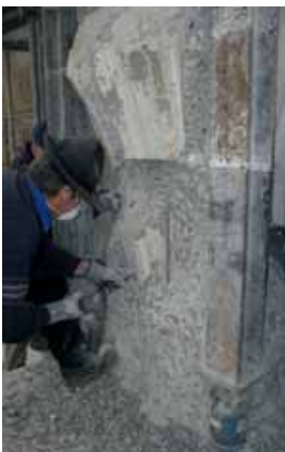
Abb. 6: Mühevollle Entfernung des Betonkerns der Unterbauung von den Maßwerksteinen der Konsole, die ohne Trennschicht in den hochfesten und verdichteten Beton förmlich eingegossen war. Zu erkennen sind zwei der drei eingebauten Stahlprofile auf Hydraulikpressen, die mit jeweils 20 t angepresst wurden, um dem Druck des Pfeilers entsprechende Kräfte entgegenzusetzen.
