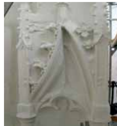
Abb. 2: Fehler eines Steinmetzen
