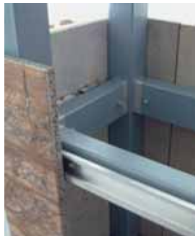
Ecken wurden fugenlos auf Gehung geklebt. Befestigt wurde mittels BWM-Befestigungstechnik auf UK ATK 103.
