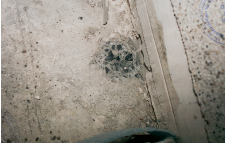
Fest an die Wand anbetonierter Treppenlauf ohne Entkopplung
