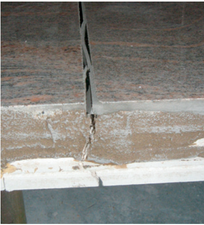
Bruch der Bodenkonstruktion bei 22 KN Punktlast
