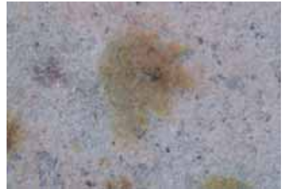
Verfärbung, verursacht durch die Reaktion eisenhaltiger Minerale (z. B. Pyrit) mit alkalischer Feuchtigkeit aus dem Verlegesystem in Verbindung mit Sauerstoff
