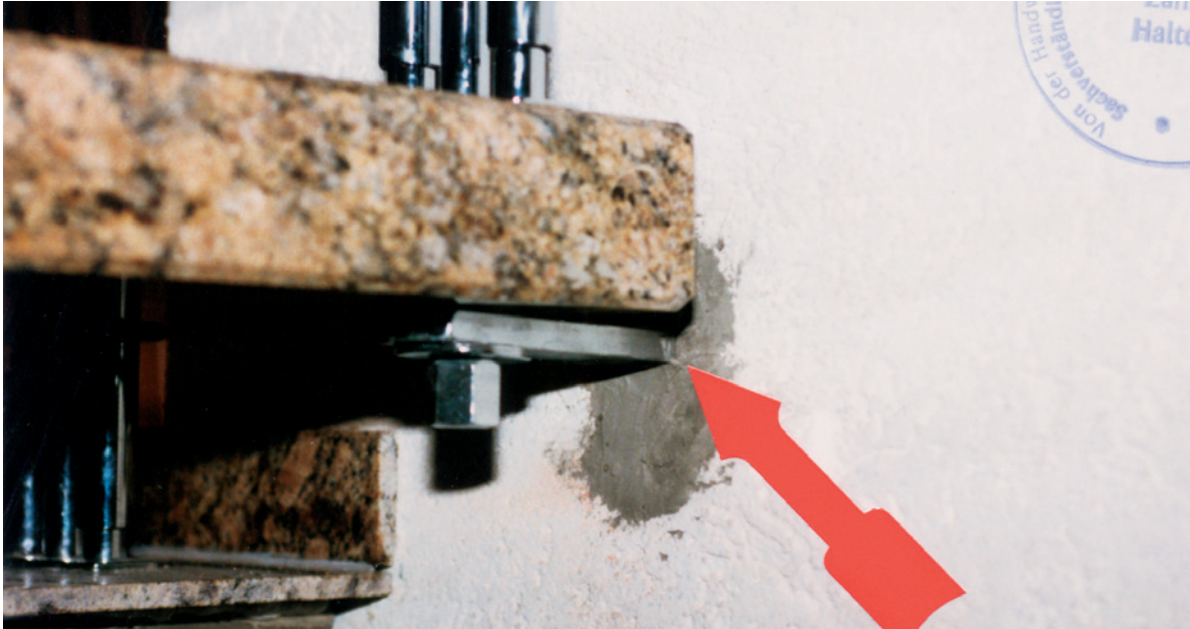
Bemängelter Haarriss im Montagemörtel, Auflager Wandanker punktuell
