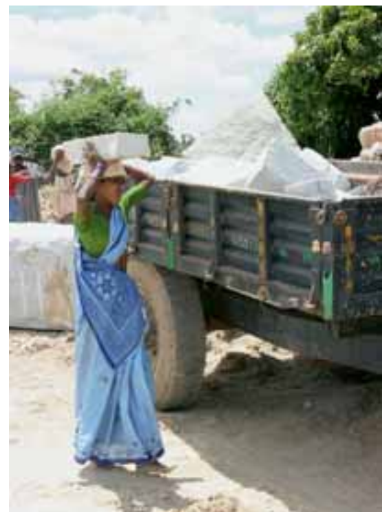
Geladen werden hier VISCOUNT WHITE-Abfallsteine für die Zerkleinerung zu Baumaterial für den lokalen oder regionalen Gebrauch
