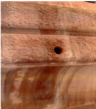
Arkadenteil mit rostbrauner Verfärbung (Entnahmestelle des Bohrkerns 1)
