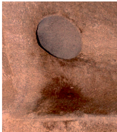
Teil der Arkade mit dunkler Verfärbung (Entnahmestelle des Bohrkerns 3)
