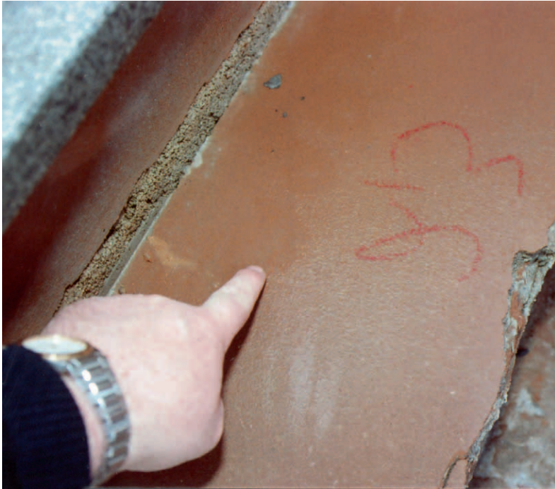
Feuchtigkeit auf Mörteloberseite
