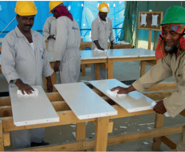
Imprägnierung der Fassadenelemente: Nach dem Auftragen von AKEMI Antifleck Super, werden die Überstände der Imprägnierung abgewischt
