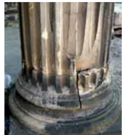
Konstruktiv bedingte Risse in den Säulen, die bei thermischer Belastung nur nach Osten ausweichen konnten; links und rechts sind sie zwischen Commun und Triumphptor eingeklemmt.
