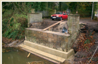
Brückenwiderlager vor der Restaurierung mit dem »Zahnfleischfundament« im Bereich der Eingangszone
