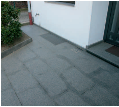
Verfleckung durch ein herkömmliches Verlegesystem mit Mörtel 0-2
