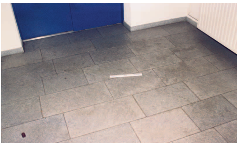
Flecken vor dem Aufzug
