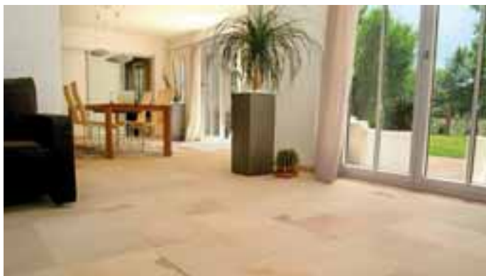
Bruchraue Oberflächen im Innenbereich
