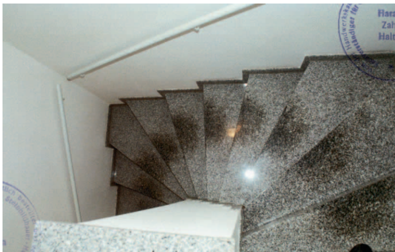
Fettflecken auf der Kellertreppe
