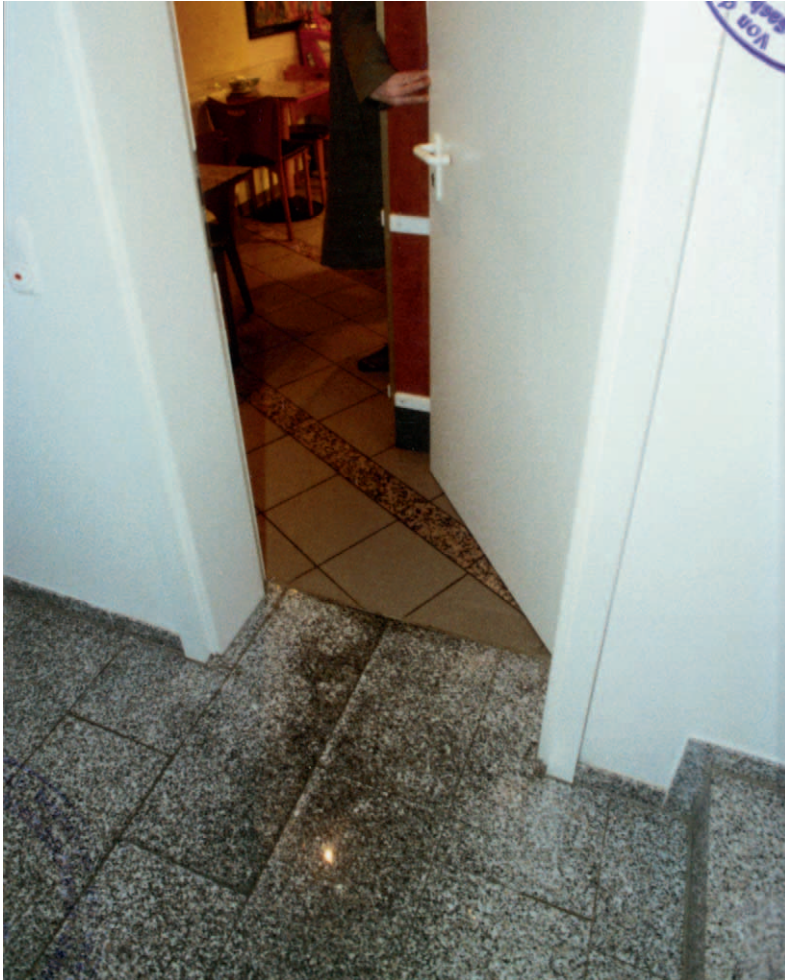
Fettflecken am Ausgang Cafe auf den Bodenplatten des Flures
