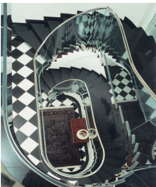
Vom Steinmetzmeisterbetrieb Egger ausgeführte Treppe aus NERO ASSOLUTO BELFAST in einem Privathaus am Wörthersee
