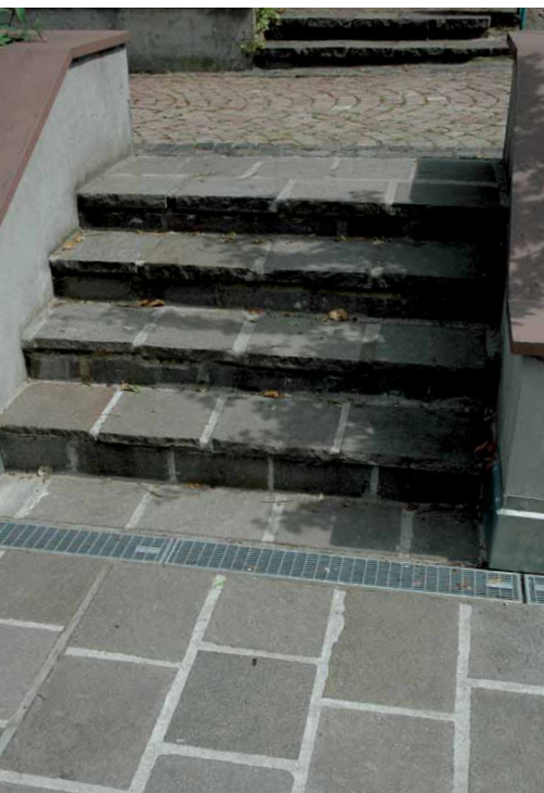
Das gesamte Oberflächen- und Sickerwasser wird in den Drainkanal geführt.
