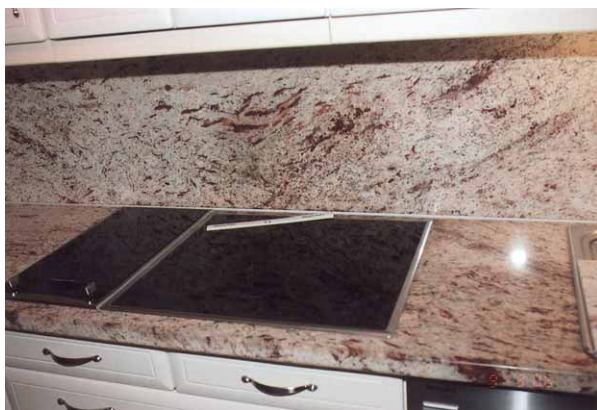
Verfleckung der Arbeitsplatte und der Rückwand im Herdbereich
