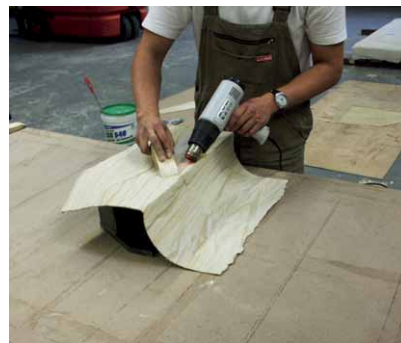
Mit der Heißluftdüse kann man das Sandsteinfurnier an praktisch jede Unterlage anpassen.
