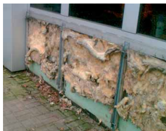
Keine Seltenheit: Mangelhafter Dämmzustand unter einer Fassade
