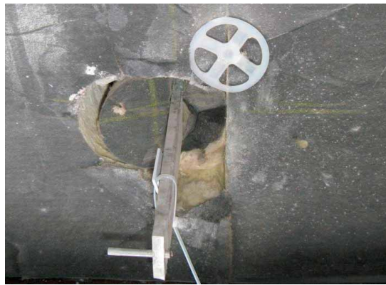
Abb. 6: Wärmebrücke durch lückenhafte Dämmung
