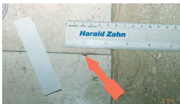
Bild 1: Kantenabplatzung an einer Bodenplatte
