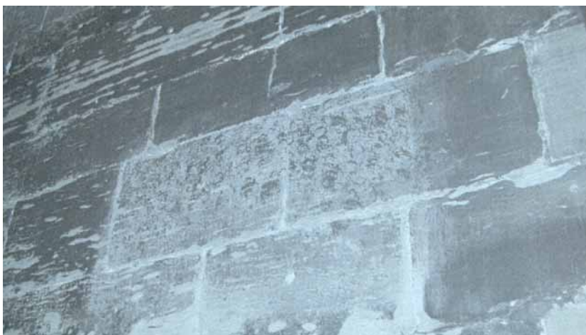
Sandstein mit typischen Schäden
