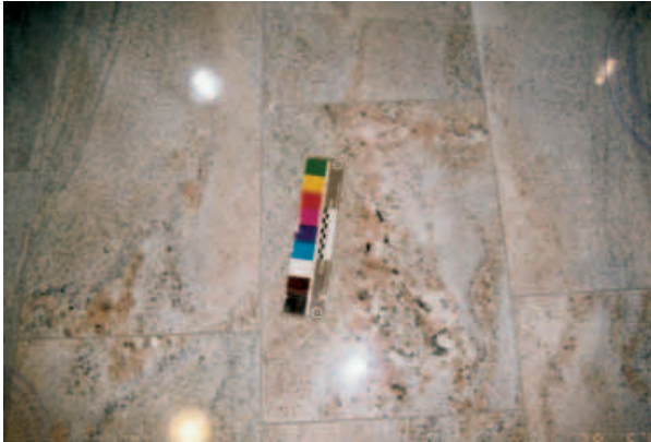
Bild 3: Stark strukturierte Bodenplatten
