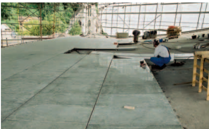
Hier wird das Dachfenster, das zur Kontrolle und für Wartungsarbeiten unerlässlich ist, mit passgerechten Schnittplatten »nahtlos« eingerahmt.
