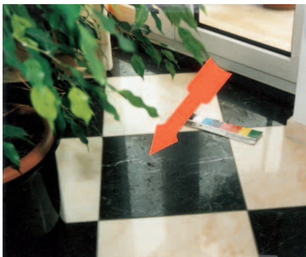
Im Gegenlicht deutlich zu erkennen: Abplat- zungen an der Oberfläche der dunklen Platten
