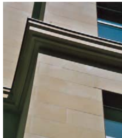
Fassadendetail mit Platten und Massiv-Gesimssteinen aus UDELFANGER SANDSTEIN; keine Gehrungsschnitte an den Kanten
