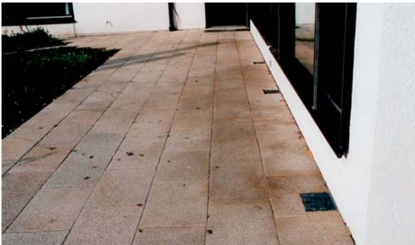
Der Plattenbelag ist milchig weiß verfärbt. Schadensursache: Wassereintritt, bevor der Mörtel abgebunden hatte.
