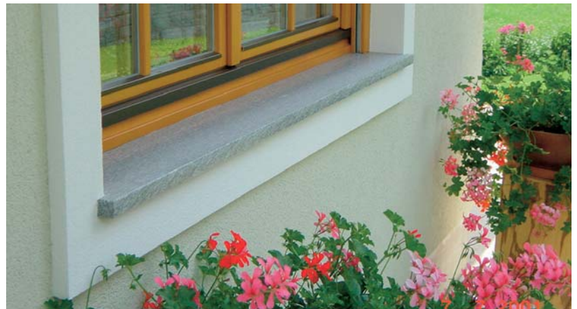
An dieser Fensterbank aus TAUERNGNEIS fehlt das Gefälle »nach vorn«.
