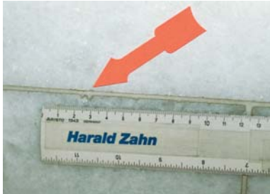
Mäusezähnen an der Kante einer Bodenplatte
