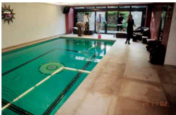
Bodenplatten mit zu geringem Gefälle im Schwimmbad
