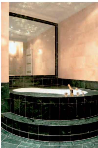
Von KMD ausgeführtes Nobelbad.
