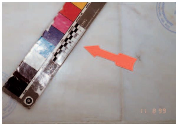
Milchiger Anriss in einer Bodenplatte.
