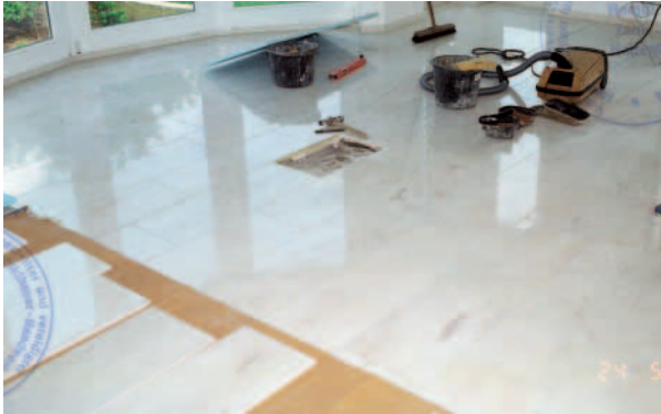
Geöffnete Oberfläche: Estrich ohne Riss.
