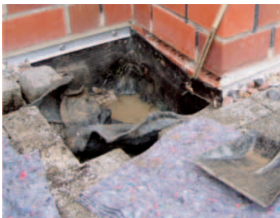
Unzureichende Anschlusshöhe außerhalb eines Tür- oder Fensterelements. Die Folie der Z-Sperre entwässert hinter der Wandanschluss-Schiene.
