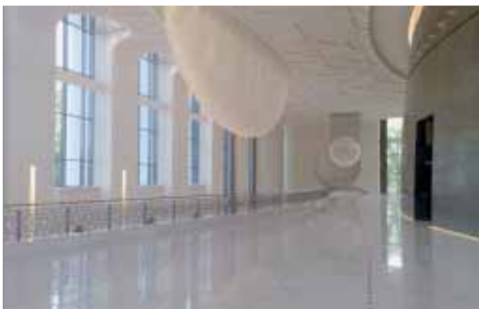
Bei diesem Bauvorhaben wurde im Diamant-Nass-Schleif-Verfahren geschliffen und in Nass-Kristallisation auspoliert. Foto: MGB
