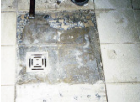
Keine Anschlussmöglichkeit der Verbundabdichtung an das Aufstockelement (Bodenablauf). Der Schaden bzw. die Undichtigkeit ist vorprogrammiert.
