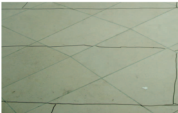
Typisches Rissbild eines Belags auf einem Trockenhohlboden
