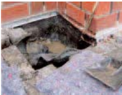
Unzureichende Anschlusshöhe außerhalb eines Tür- oder Fensterelements. Die Folie der Z-Sperre entwässert hinter der Wandanschluss-Schiene.
